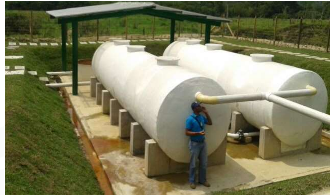
Planta tratamiento aguas residuales – Santa Rosa de Osos, Corregimiento el Caney
