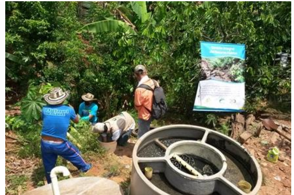
Tanques instalados, municipio de Entrerriós
