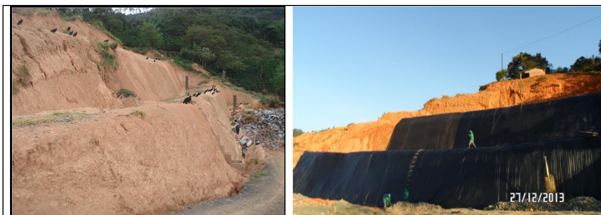
Relleno sanitario Municipio Ciudad Bolívar (2013) Relleno sanitario Municipio Ciudad Bolívar acondicionado
