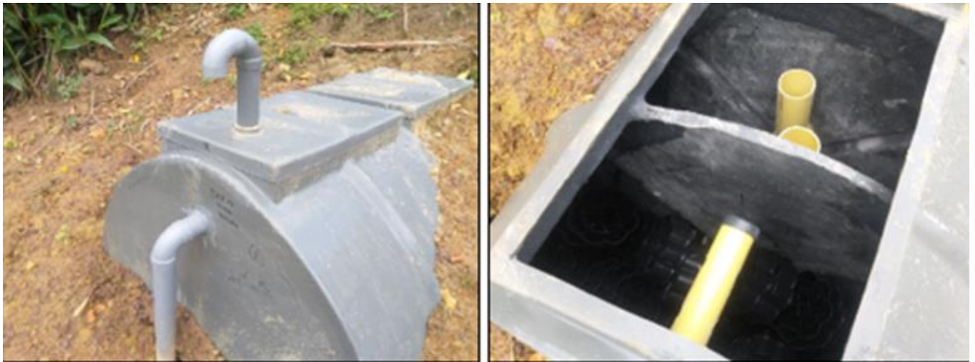
Fotografía. Sistema séptico instalado en el municipio de Anorí
