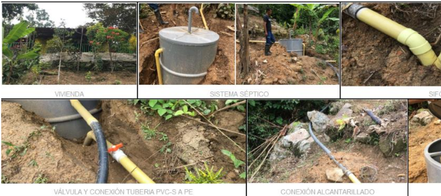
Fotografía. Sistema séptico instalado en el municipio de Caracolí
