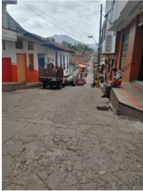
Foto. Recorrido por los tramos de colectores a intervenir en el municipio de Támesis
