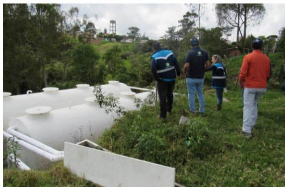
Fotografía. Planta de Tratamiento de Aguas Residuales- Santa Rosa de Osos
