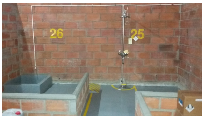
Foto. Punto clasificación y separación de residuos sólidos
